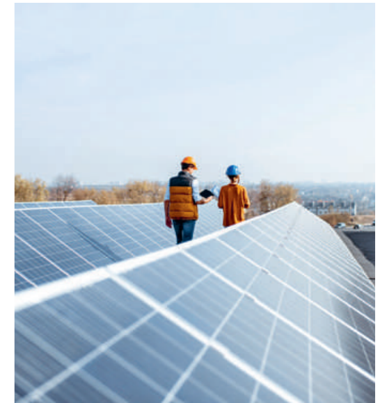
Gerflor mise fortement sur l'énergie photo-voltaïque pour améliorer son mix énergétique. 68 000 m 2 de photovoltaïque installé.
